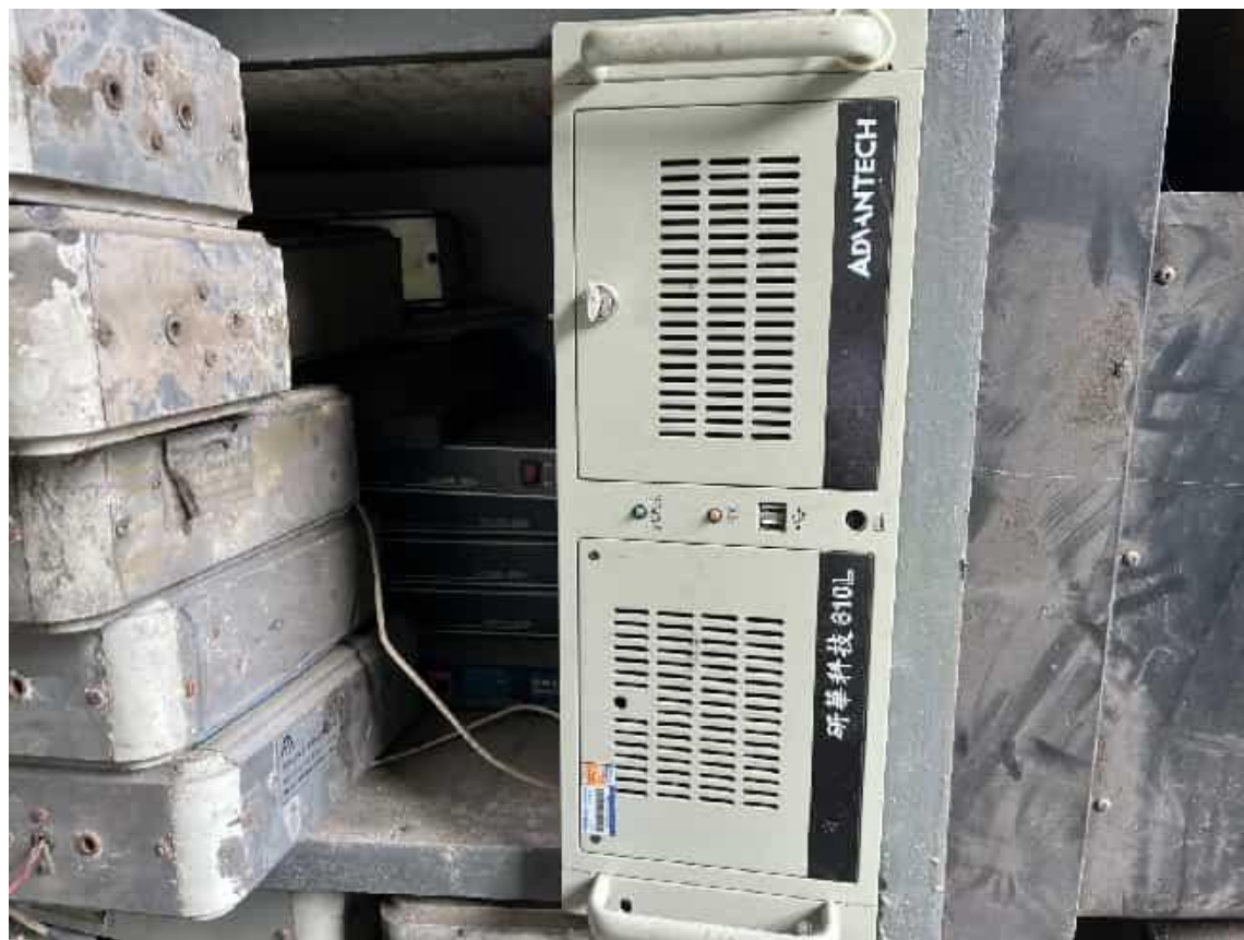
隧道机电设备59-工控机 (2)
