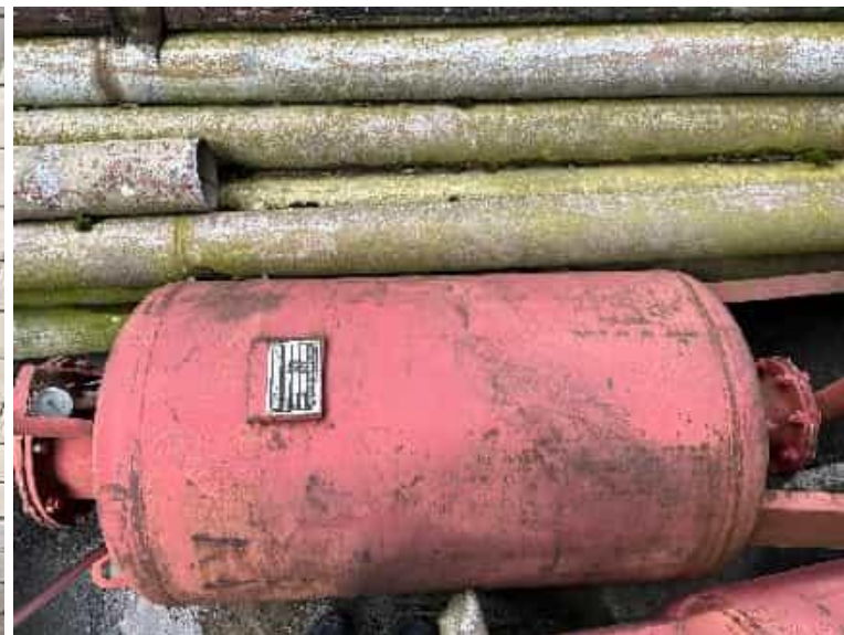
隧道机电设备6 -隔膜气压罐 (3)
