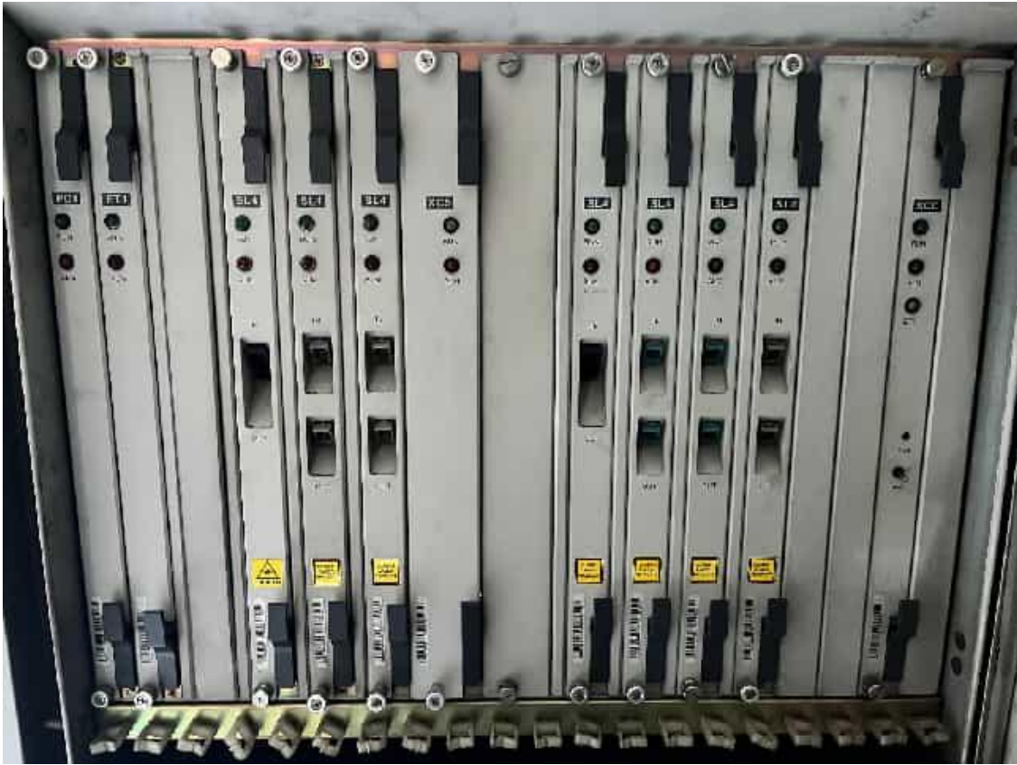
收费系统部分9-光综合业务接入网光网络单元（7）
