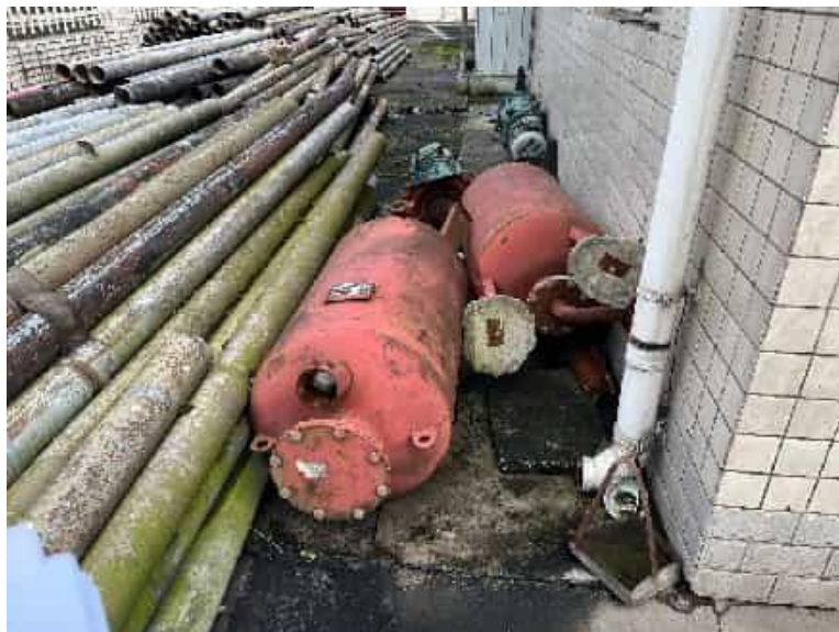
隧道机电设备6 -隔膜气压罐 (2)
