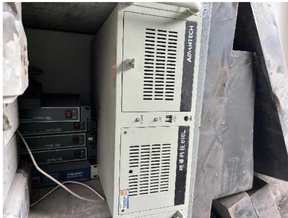
隧道机电设备59-工控机 (3)
