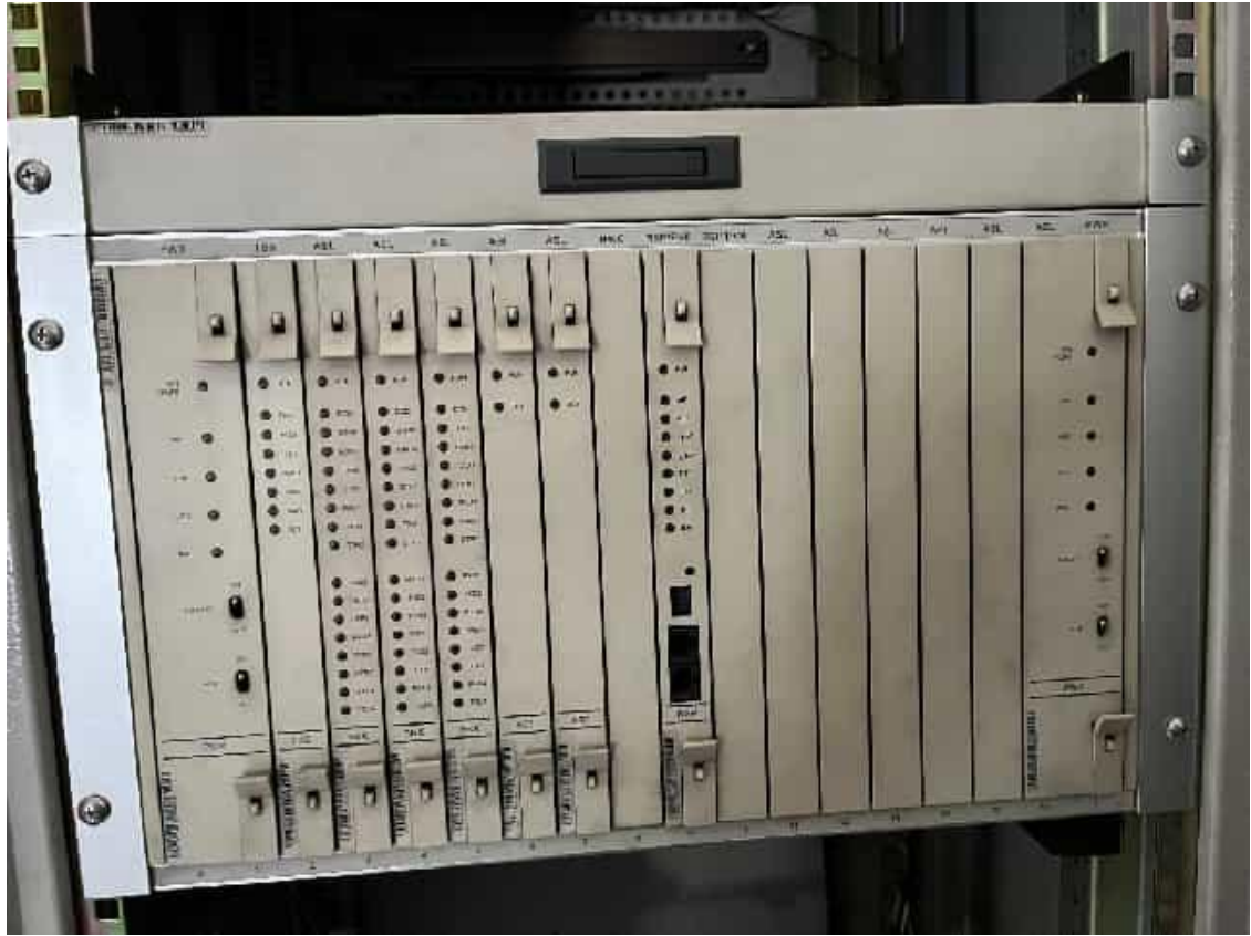
收费系统部分9-光综合业务接入网光网络单元（11）
