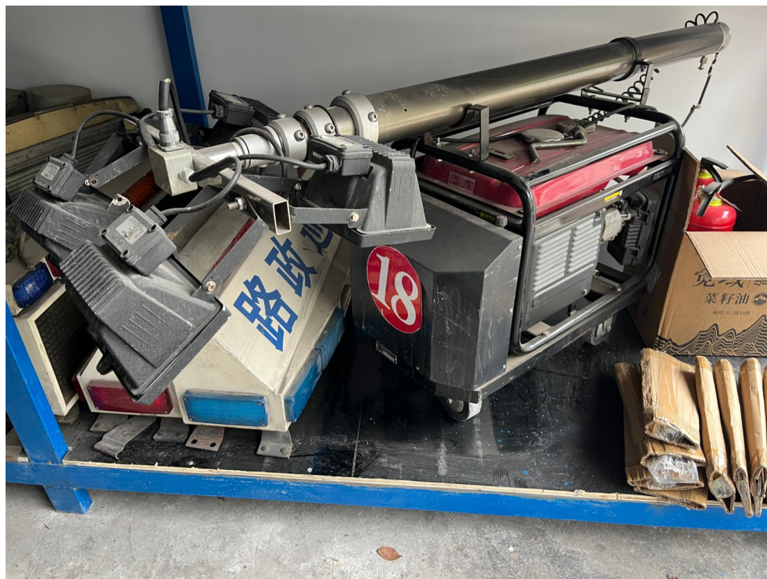
安全设施26-曲臂升降式照明灯 (4)
